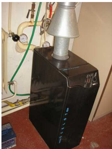
Plynový kotel pro ÚT v přízemí.
